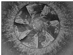
腐食した排水ポンプ場の羽根車
