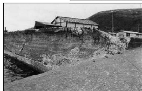
老朽化した海岸堤防
