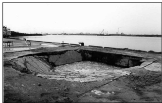
港湾施設エプロン部分の陥没
